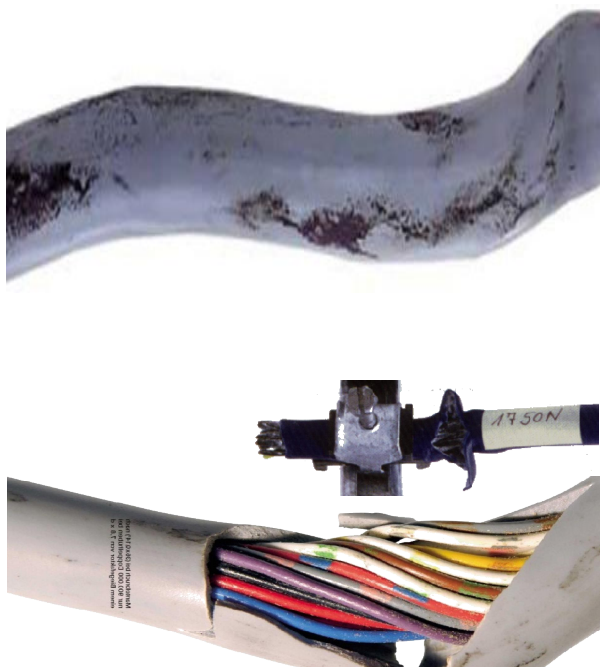
Slika 3: pogoste napake - zvijanje kabla in bule zaradi vodnika, ki se je prepletel s sosednjim vodnikom - počen plašč zaradi tlaka v osni smeri - počen plašč zaradi torzije
